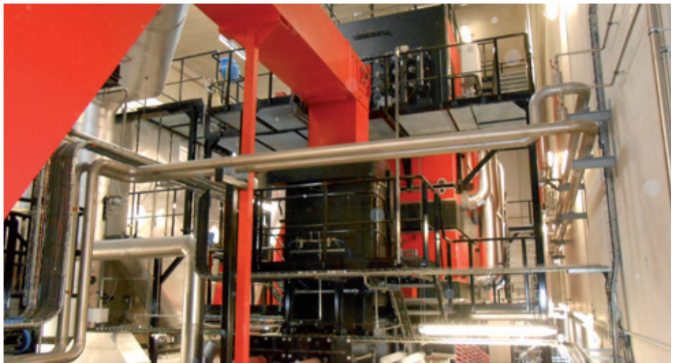
Intérieur de la chaufferie biomasse
